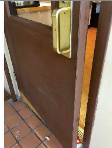
PHOTO 10 Fire Door Assumed ACM
